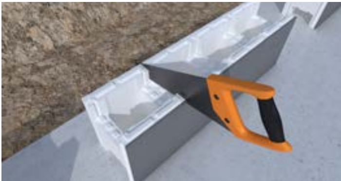
11 Si vous devez faire une coupe d'un bloc, toujours couper au milieu d'une entretoise en suivant les marquages
